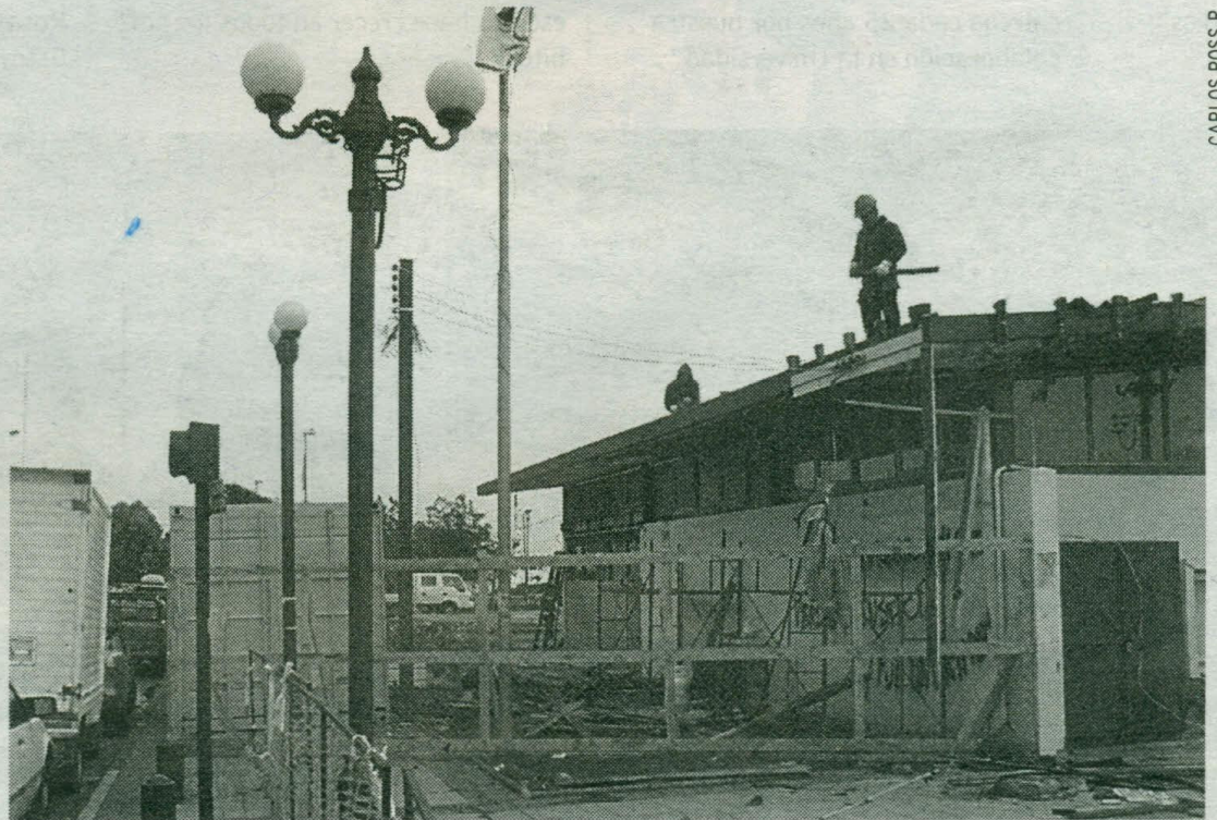
Equipos de obreros ya se encuentran trabajando de lleno en la construcción.
